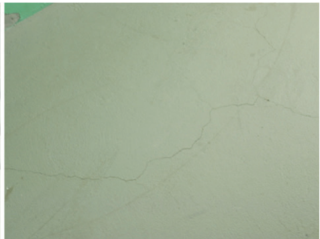
Exemplo 2: Fissuras no piso
