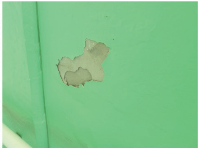
Exemplo 6: Descolamento de tinta e esfarelamento do reboco
