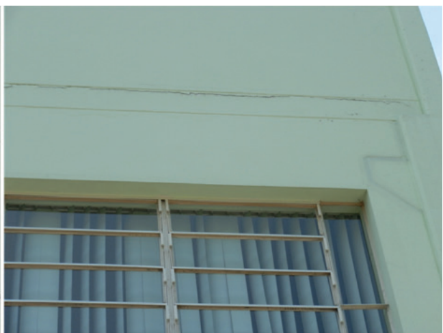
Exemplo 4: Fissura horizontal acima de viga
