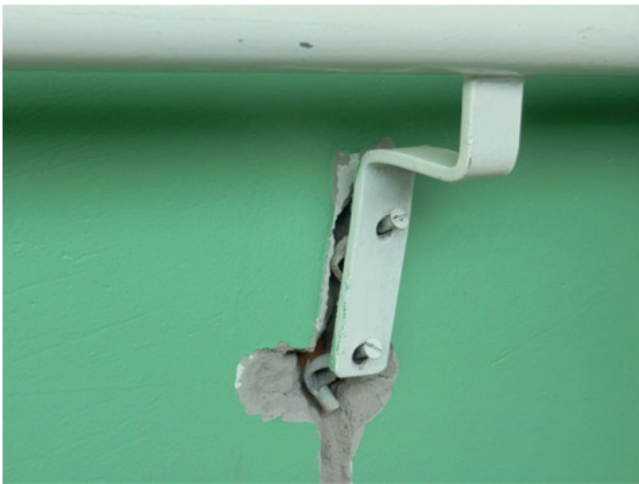
Exemplo 5: Desgaste na estrutura de fixação de corrimão
