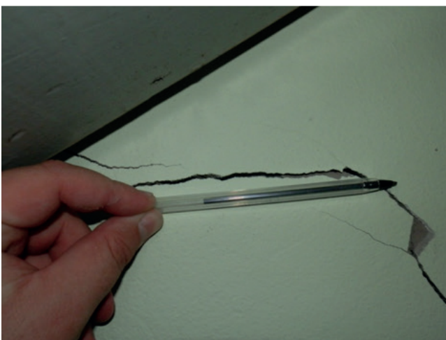
Exemplo 3: Rachadura em parede
