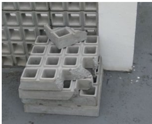
Parede mal executada e com risco de desmoronamento em creche de Palhoça (SC), representando risco aos usuários do prédio (fotos tiradas em 06.03.19 por voluntários do Observatório Social de Palhoça)
